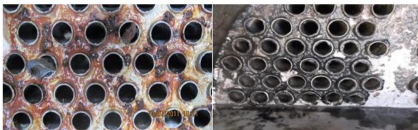
FIGURA N°3: Biofilm en condensadores e intercambiador de calor.
